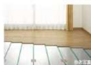
ガス温水式床暖房
